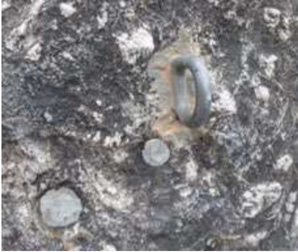
Abrazadera de titanio que reemplazó una protección de acero inoxidable en orillas del mar en Rio de Janeiro (Brasil). Note los dos puntos con durepox que eran los agujeros de las protecciones antiguas. El durepox fue utilizado para dejar el agujero antiguo más camuflado con la roca, minimizando el impacto visual (Kika Bradford).
